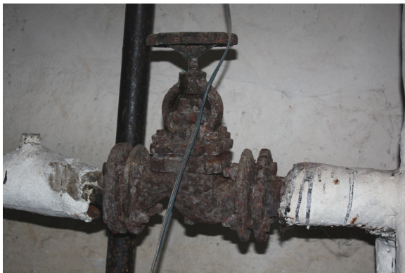
Foto Nr. 78. Maģistrālo cauruļvadu ventiļi ir korodējuši; tie nepilda noslēgarmatūras funkcijas
