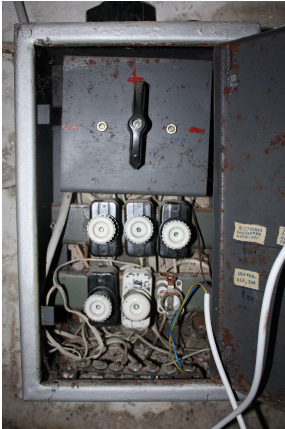
Foto Nr. 87. Elektriskie kabeļi tiek atklāti pieslēgti pie fāzes un neitrāles. Elektroviroga durtiņas atrodas atvērtā stāvoklī
