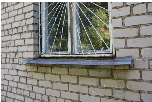
Foto Nr. 49. Koka loga rāmji ir izkaltuši, sarozījušies un ir izkustējušies. Logu furnitūra ir vai nu bojāta vai nu tās nav vispār. Plaisas loga rāmju un sienu sadurvietās. Piedurlīstes ir nodilušas. Veicot ārējo sienu siltumpretestības paaugstināšanu, logi ir jāmaina
