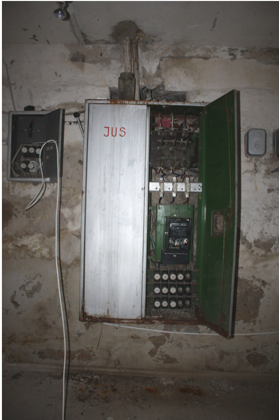
Foto Nr. 85. Galvenā elektrosadale atrodas pirmsavārijas stāvoklī. Sadales durtiņas neaizveras
