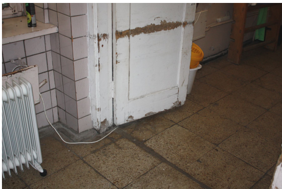
Foto Nr. 47. Iekšējo durvju funkcionāli estētisks stāvoklis ir neapmierinošs. To tehniskais stāvoklis nenodrošina durvju vieglu kopšanu
