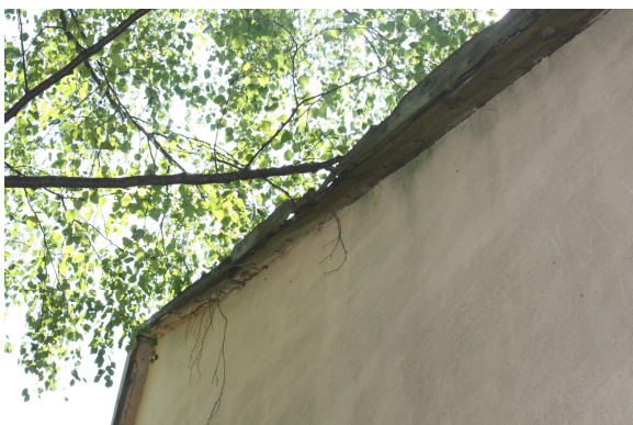
Foto Nr. 30. Jumta klāja (latojuma) ārējā daļa ir bioloģiski bojāta
