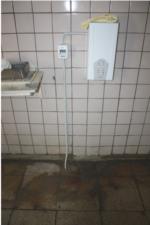
Foto Nr. 74. Karstā ūdensvada elektriskais sildītājs. Elektriskais sildītājs tika uzstādīts pēc tam, kad ēkai tika pārtraukta centralizētā siltuma piegāde
