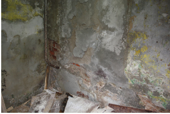
Foto Nr. 76. Sarūsējuši apkures sistēmas cauruļvadi (telpa Nr. 2 pazemes stāvā)
