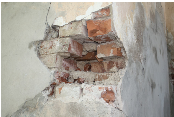
Foto Nr. 14. Mūra posmiem, kas atrodas Ziemeļaustrumu pusē ir konstatēta dziļa korozija. Javai nav saistes spējas, tai konstatēta destrukcija visas sienas biezumā
