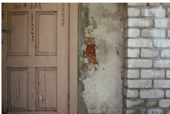
Foto Nr. 20. Mūra posmiem, kas atrodas Ziemeļrietumu pusē ir konstatēta dziļa korozija. Javai nav saistes spējas, tai konstatēta destrukcija visas sienas biezumā, ķieģeļiem ir konstatējama destrukcija
