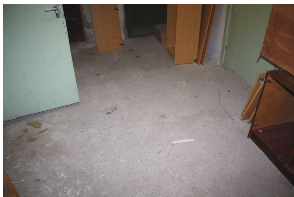
Foto Nr. 39. Telpa Nr. 4. Betona grīda ir plaisājusi
