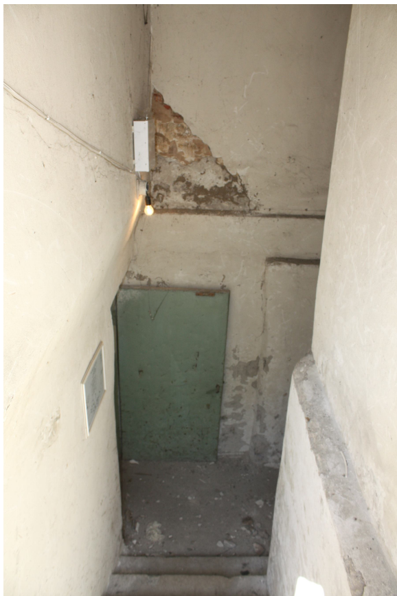
Foto Nr. 25. Kāpņu telpa uz pazemes stāvu. Sienas daļai ir konstatēta dziļa korozija (sk. kopā ar Foto Nr./Nr. 11 – 13)
