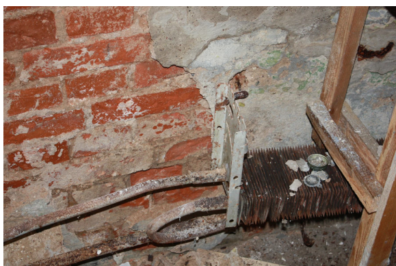
Foto Nr. 81. Avarējis apkures konvektors (telpa Nr. 2 pazemes stāvā)
