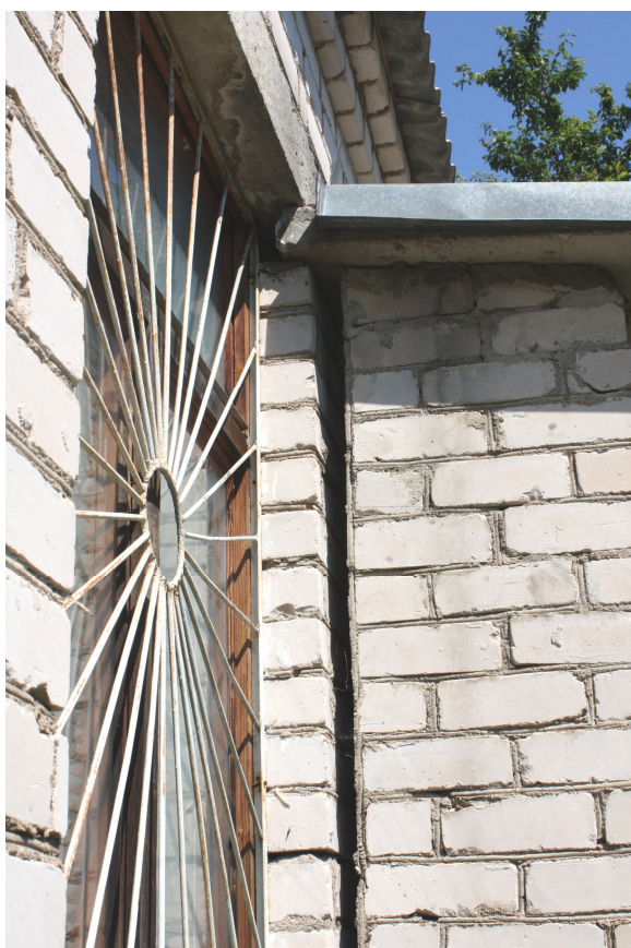
Foto Nr. 17. Foto Nr. 16 tuvplāns. Daļēji ventkamas sienas iespīlētas starp pamatiem un jumta plātni, kas, savukārt, iespīlēta starp ailstarpu un loga pārsedzi. Ventkamas sienas atrodas pirmsavārijas stāvoklī
