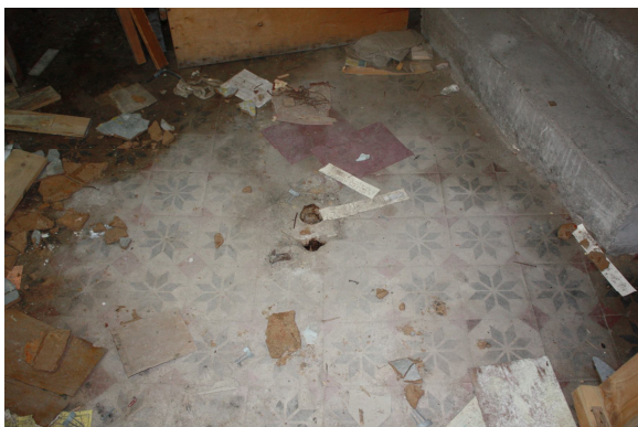
Foto Nr. 69. Kanalizācijas sistēmas notekas pagrabstāvā. To funkcionēšana ir pārtraukta
