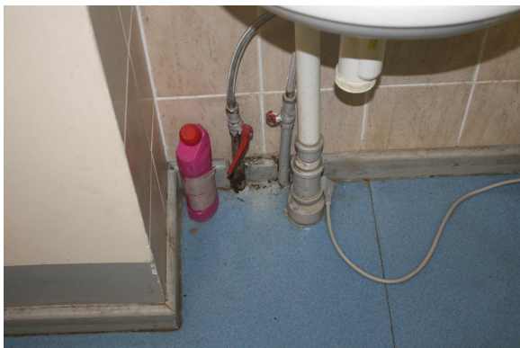
Foto Nr. 67. Ūdensvada cauruļvada korozija, krāsojuma noslāņošanās
