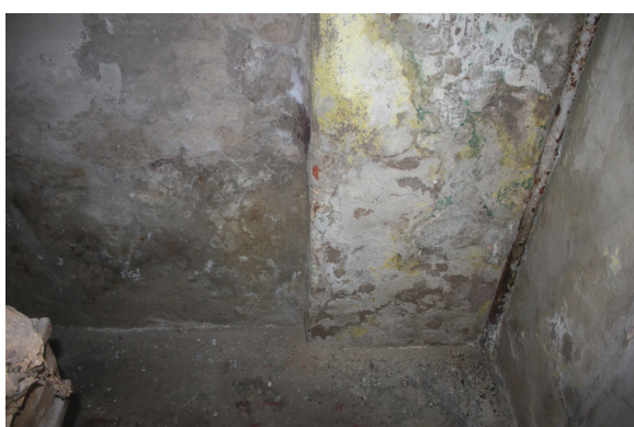
Foto Nr. 24. Telpa Nr. 1. Pazemes stāvā sienām, kas saskaras ar grunti mitruma ietekme ir konstatēta visā to augstumā
