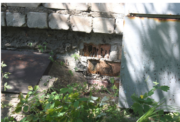
Foto Nr. 15. Jaunā korpusa cokoldaļas caurumotiem māla ķieģeļiem ir konstatēta destrukcija, vairākās vietās apmetums ir nolobījies. Caurumoto ķieģeļu pielietošana cokoldaļu mūrēšanā nav pieļaujama. Situāciju pasliktina bojājusies aizsargapmale, kas nenodrošina lietus ūdens novadīšanu prom no ēkas pamatiem
