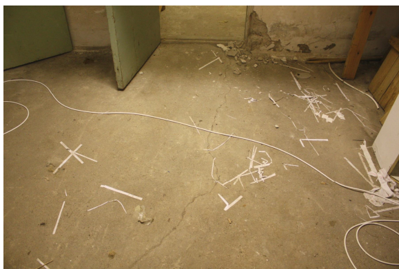
Foto Nr. 38. Telpa Nr. 9. Betona grīda ir plaisājusi
