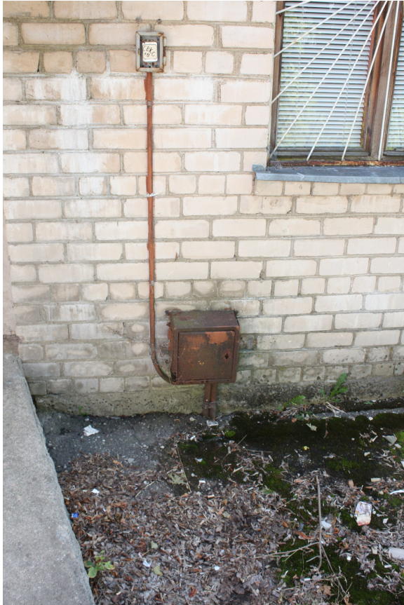
Foto Nr. 94. Abonenta ārējā elektrosadale. Sadales korpuss ir sarūsējis. Sadales, kā arī slēdža korpasa aizsardzība pret mitruma (ūdens) iekļūšanu netiek nodrošināta
