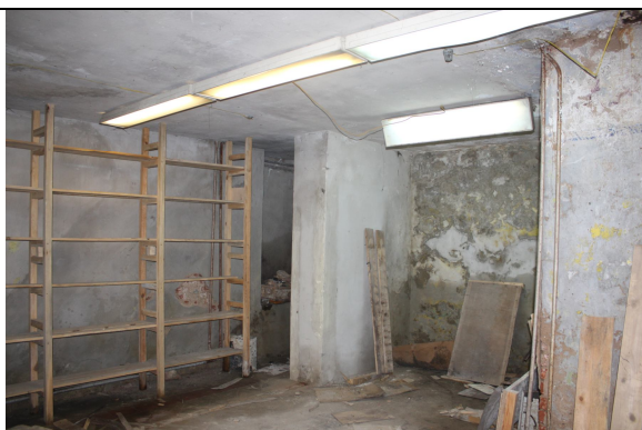
Foto Nr. 22. Telpas Nr. 2 kopskats. Sienām, kuru virsma kontaktējas ar grunti ir konstatēta augsta mitruma ietekme, kas netieši ļauj pieņemt, ka ārējām pazemes stāva sienām hidroizolācija nav ierīkota vai nav saglabājusies un nepilda savas funkcijas
