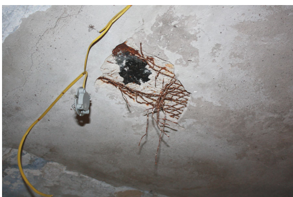
Foto Nr. 29. Vairākas pagraba stāva pārseguma metāla sijas ir apmetas pa sietu, kas uzlabo apmetuma saķeri ar metāla siju, taču vietās, kur ir saskatāmas metāla korozijprocesu pazīmes, tā virsma ir apstrādājama ar rūsas pārveidotājiem un apstrādājama ar gruntskrāsu un pretkorozijas krāsojumu saskaņā ar ražotāja rekomendācijām
