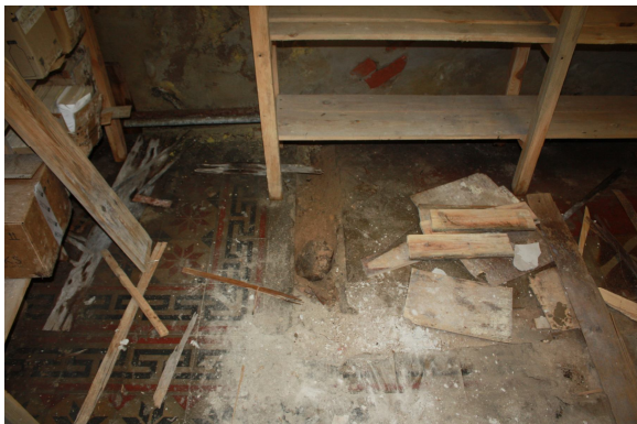
Foto Nr. 68. Kanalizācijas sistēmas notekas pagrabstāvā. To funkcionēšana ir pārtraukta
