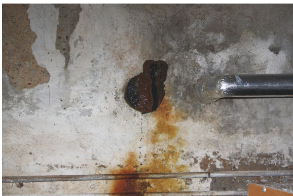
Foto Nr. 70. Siltummezglā un ūdens mērīšanas mezglā (telpa Nr. 6) no kanalizācijas cauruļvada izvada pilnā fekālijas notekūdens. Telpas grīdas ir appludinātas. Ir saožama raksturīga fekāliju smaka
