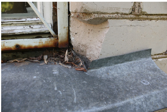
Foto Nr. 50. Logu palodžu un sienu sadurvietas nav hermētiskas, kas negatīvi ietekmē mūri, kā arī ēkas iekšējo apdari. Renovācijas laikā mainot logus un loga palodzes tie hermētiski jāiestrādā sienas konstrukcijās
