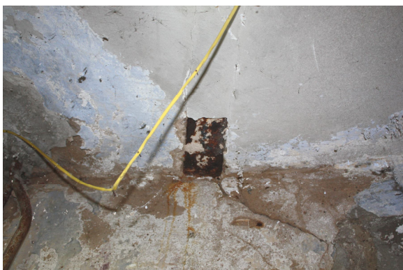
Foto Nr. 28. Ir konstatēta pagrabstāva metāla siju korozija; vietās kur uz metāla sijām nav saglabājies apmetums, korozijas pakāpe ir dziļāka, taču pārseguma nestspēja nav apdraudēta
