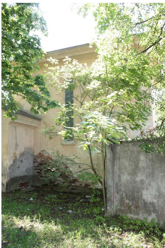
Foto Nr. 11. Šī ēkas daļas siena atrodas neapmierinošā tehniskajā stāvoklī. Neizbūvētas apmales, neorganizētās lietusūdens novadsistēmas dēļ mūrim ir dziļa korozija (mūra destrukcija ir konstatējama visā biezumā). Situāciju pasliktina samazināts saules enerģijas daudzums Ziemeļrietumu pusē, kā dēļ sienas paliek mitras arī vasaras periodā, tās nespēj izžūst vasaras perioda laikā, kā dēļ pie negatīvām temperatūrām caursalst. Siltuma enerģijas deficīta apstākļos iepriekšminētie mūra destrukcijas procesi norit vēl straujāk
