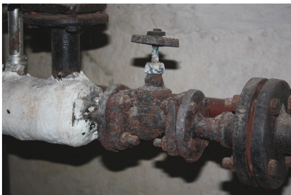
Foto Nr. 79. Maģistrālo cauruļvadu ventiļi un atloki ir korodējuši
