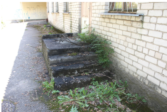
Foto Nr. 36. Lieveņis atrodas neapmierinošā tehniskajā stāvoklī; pakāpienu virsmā ir nelīdzena, pakāpieni ir sadrupuši. Nav ierīkotas līmeņu starpības norobežojošie elementi – margas
