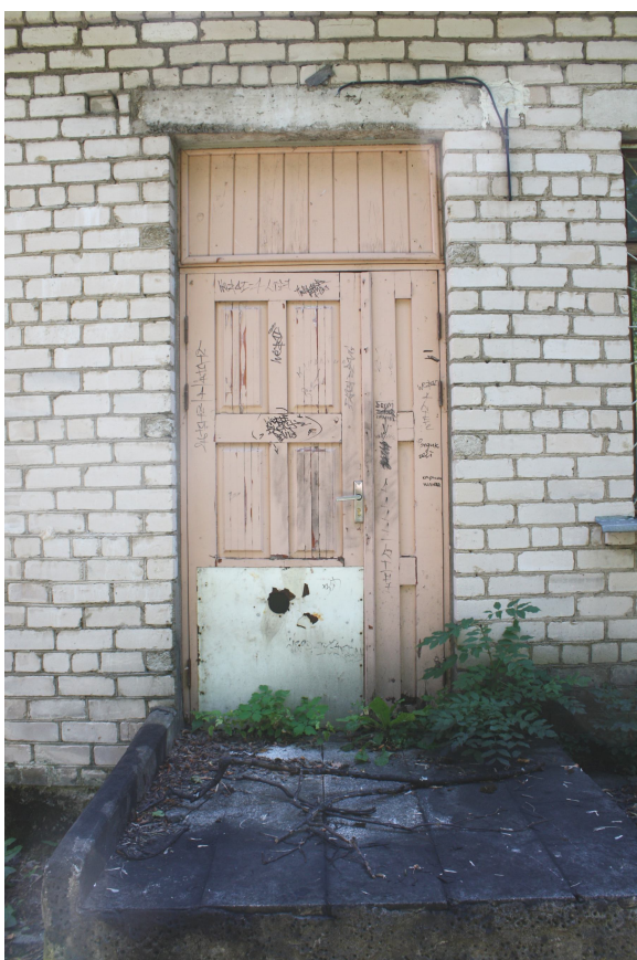
Foto Nr. 43. Ieejas durvis (telpā Nr. 8). Durvju vērtnes apakša un sliekšnis mitruma iedarbībā ir iztrupējuši
