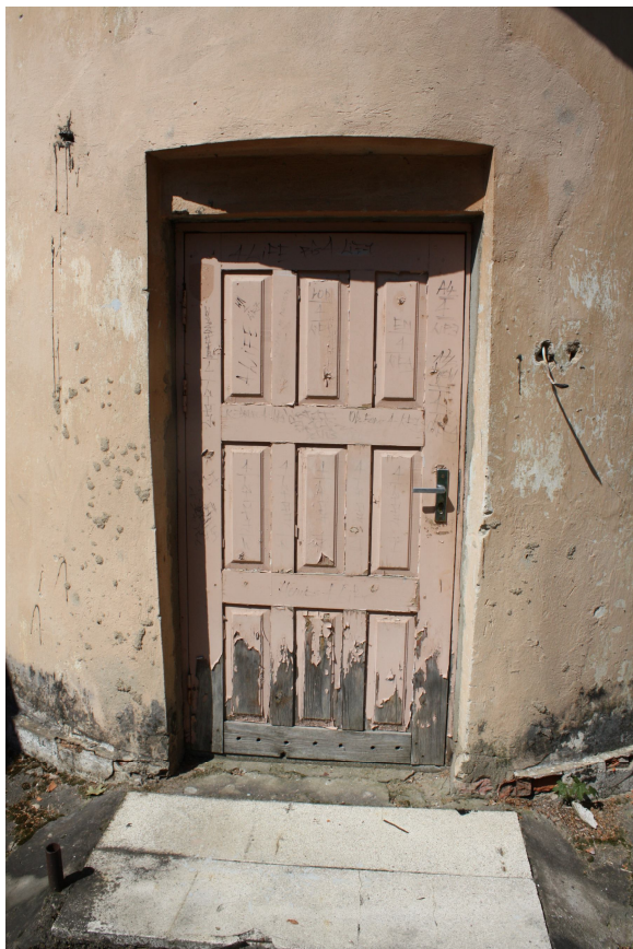
Foto Nr. 9. Neizbūvētas vertikālās hidroizolācijas, kā arī neizbūvētas apmales dēļ, pamati piesūcas ar mitrumu, bet neizbūvētas horizontālās hidroizolācijas starp cokoldaļas augšu un sienām mitruma ietekmei tiek pakļautas arī sienas. Situāciju pasliktina cokoldaļas izbīdījums
