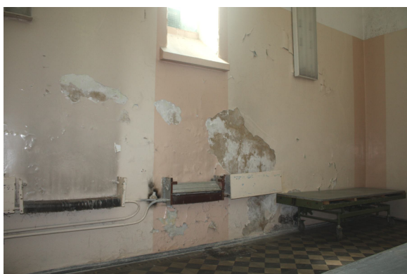
Foto Nr. 82. Neapmierinošā tehniskajā stāvoklī esoši apkures konvektori (telpa Nr. 1)
