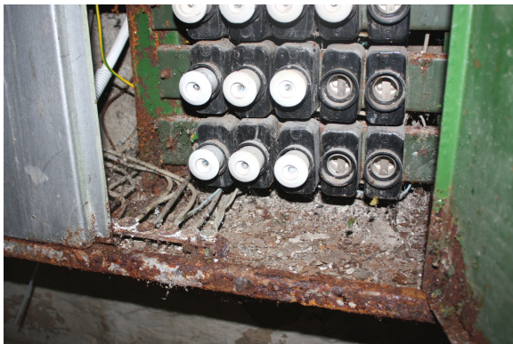
Foto Nr. 86. Foto Nr. 83 tuvplāns. Sadales neitrālei ir dziļa korozija
