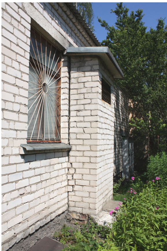
Foto Nr. 16. Ventkamas un ārējās sienas sajūguma vieta. Ir konstatēta ventkamas sienu izkļaušanās no ārējās sienas plaknes. Ir jānodrošina to stabils stāvoklis, ierīkojot metāla aptveres no plākšņu metāla un leņķprofiliem, pievelkot ar tiem pie ēkas ārējās sienas
