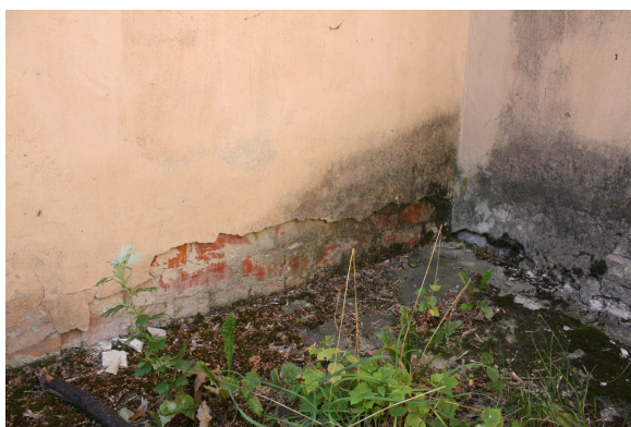
Foto Nr. 8. Pamatī ir piesātināti ar mitrumu neizbūvētās horizontālās hidroizolācijas dēļ, situāciju pasliktina bojājusies apmale
