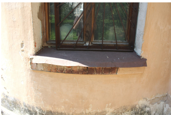
Foto Nr. 48. Vecā korpusa logu ārējās skārda palodzes ir sarūsējušas
