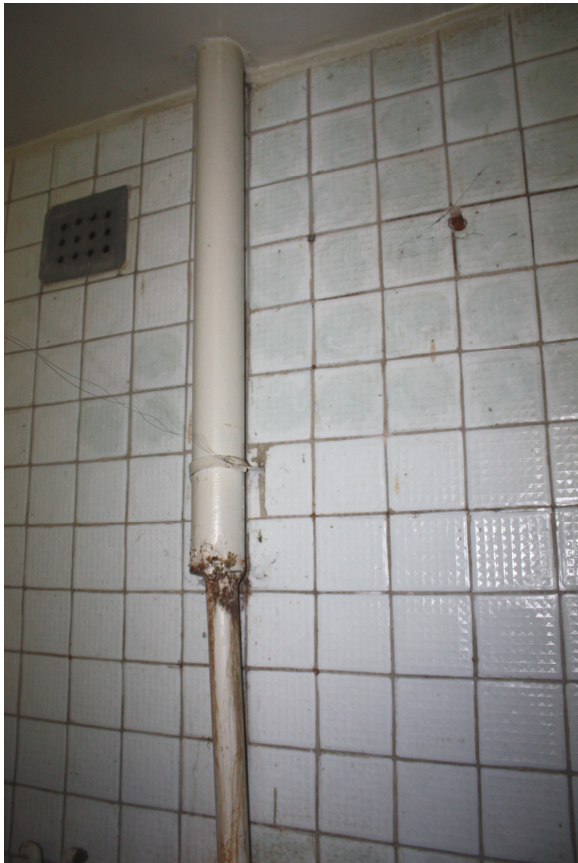
Foto Nr. 72. Kanalizācijas čuguna cauruļvadiem vairākās savienojumu vietās ir konstatēti bojājumi – sūce un rūsa
