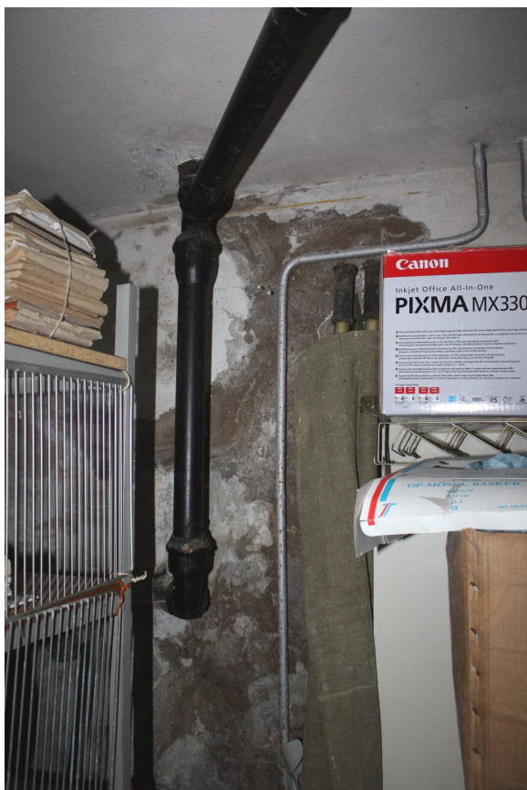
Foto Nr. 28. Telpa Nr. 3. Pazemes stāvā sienām, kas saskaras ar grunti mitruma ietekme ir konstatēta visā to augstumā
