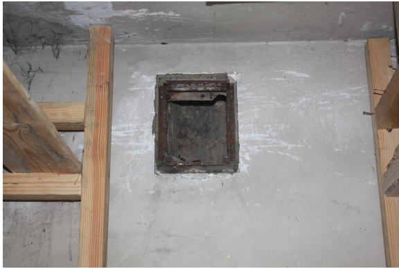
Foto Nr. 83. Ventilācijas sistēmas gaisa vadi pazemes stāvā ir korodējuši (aprūsējuši). Atsevišķiem gaisa noplūdes atvērumiem nav restu
