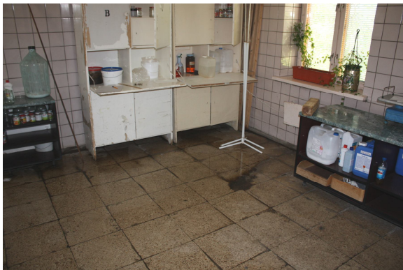
Foto Nr. 41. Telpa Nr. 7. Grīdas segums nav līdzens, telpas stūros, zem skapjiem sakrājas ūdens (pretkritumi)
