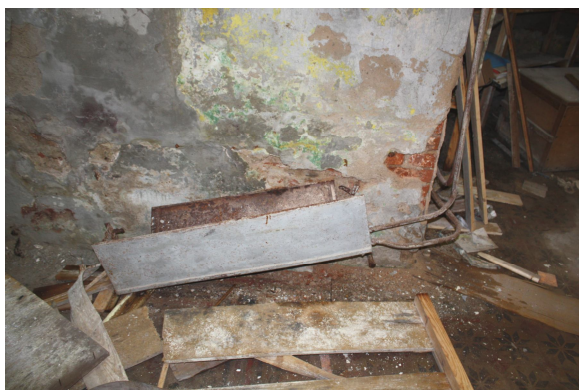
Foto Nr. 80. Avarējis apkures konvektors (telpa Nr. 2 pazemes stāvā)
