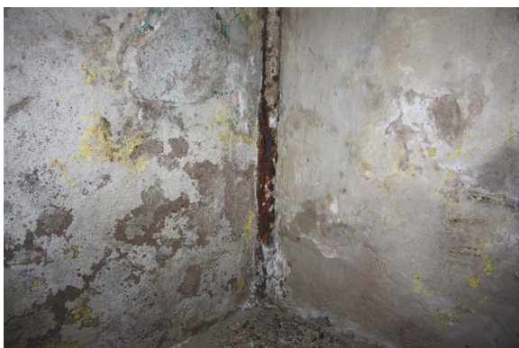
Foto Nr. 75. Sarūsējis apkures sistēmas stāvvads (telpa Nr. 1 pazemes stāvā)
