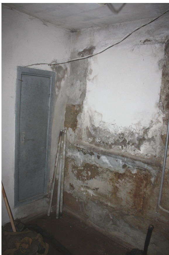
Foto Nr. 29. Telpa Nr. 8. Pazemes stāvā sienām, kas saskaras ar grunti mitruma ietekme ir konstatēta visā to augstumā
