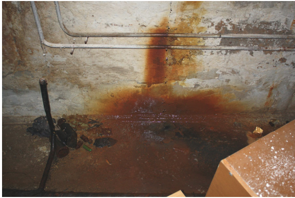
Foto Nr. 71. Siltummezglā un ūdens mērīšanas mezglā (telpa Nr. 6) grīdas ir appludinātas; agresīvie notekūdeņi negatīvi ietekmē pagraba stāva grīdu un sienas
