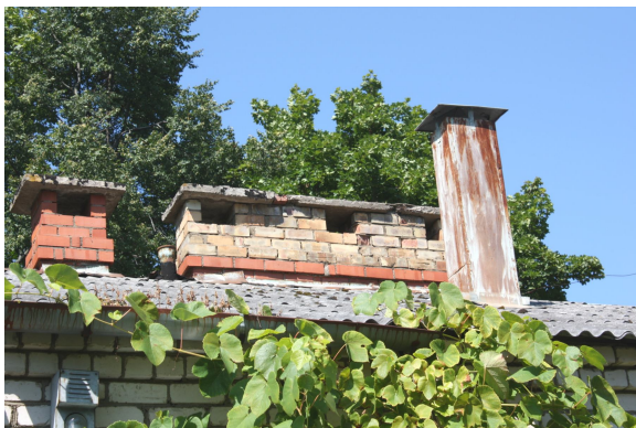
Foto Nr. 53. Ventilācijas kanālu skārda elementi ir pārklāti ar rūsu; tiem nav veikta pretkorozijas apstrāde. Ķieģeļu ventilācijas kanāliem atsevišķi ķieģeļi ūdens mitruma ietekmē drūp
