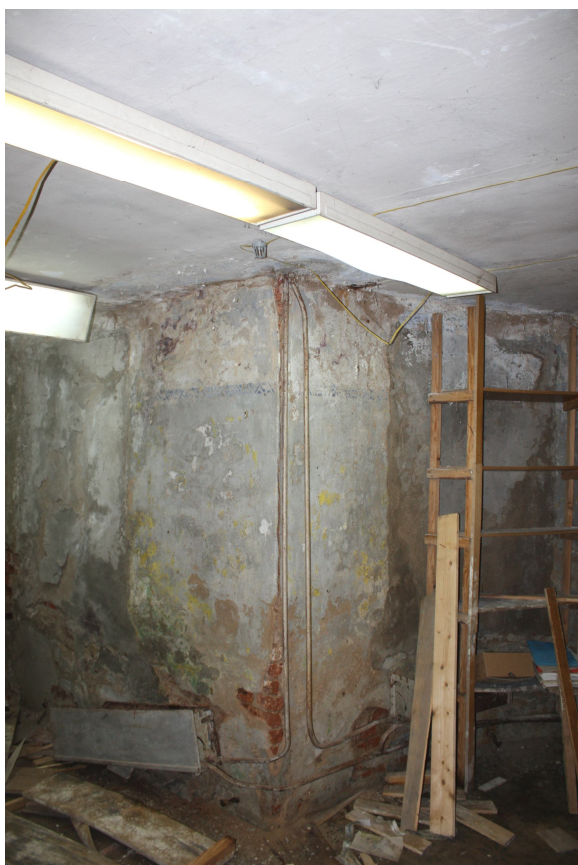
Foto Nr. 23. Telpa Nr. 2. Pazemes stāvā sienām, kas saskaras ar grunti mitruma ietekme ir konstatēta visā to augstumā
