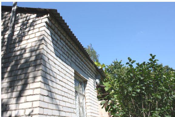
Foto Nr. 34. Teknes un notekas ir bojātās; lietus ūdens novadsistēmas darbnederīgs stāvoklis negatīvi ietekmē ēkas sienu un pamatu tehnisko stāvokli
