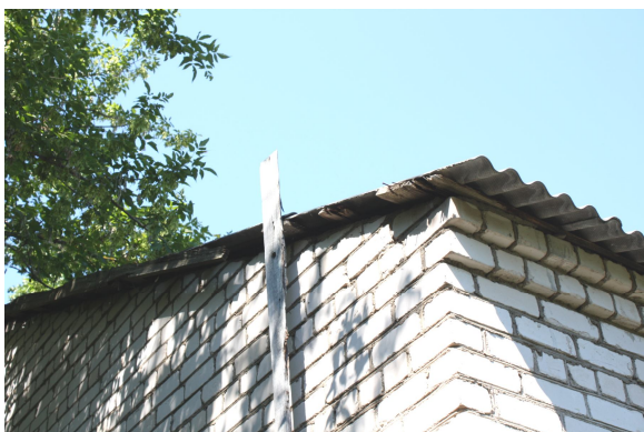
Foto Nr. 31. Jumta klāja (latojuma) ārējā daļa ir bioloģiski bojāta. Latojuma apšuvums ir bojājies pilnīgi
