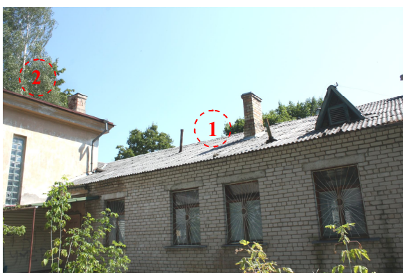
Foto Nr. 32. Jumta kopskats. 1 – virs jaunā korpusa – viļņotu azbestcements lokšņu segums; 2 – virs vecā korpusa – skārda lokšņu segums
