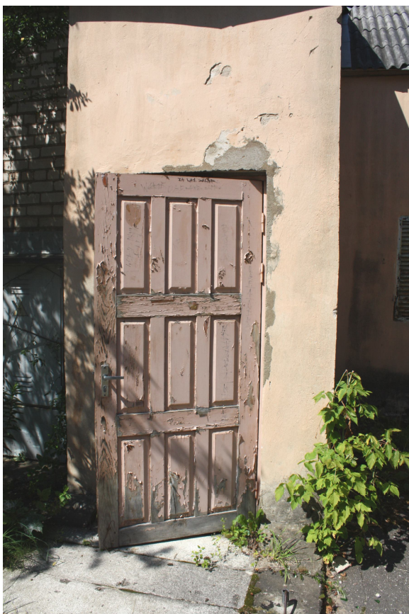
Foto Nr. 42. Ieejas durvis (pagraba kāpņu telpa). Durvju vērtnes ir nosēdušās, tām ir spraugas starp piedurlīsti un durvju vērti, sliekšnis ir pilnībā nodilis, furnitūra ir bojāta
