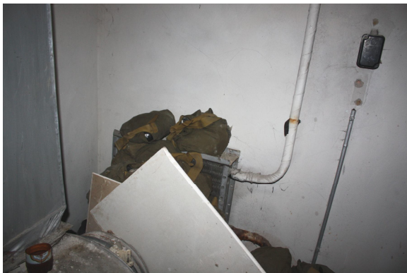
Foto Nr. 101. Pieplūdes ventilācijas sistēmas kalorifers (atrodas darbnederīgā stāvoklī)
